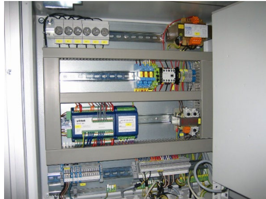
Abb. F-1 Schaltschrank
