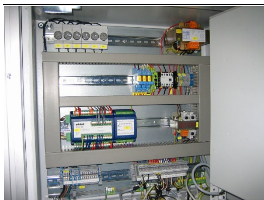
Afb. F-1 Schakelkast
