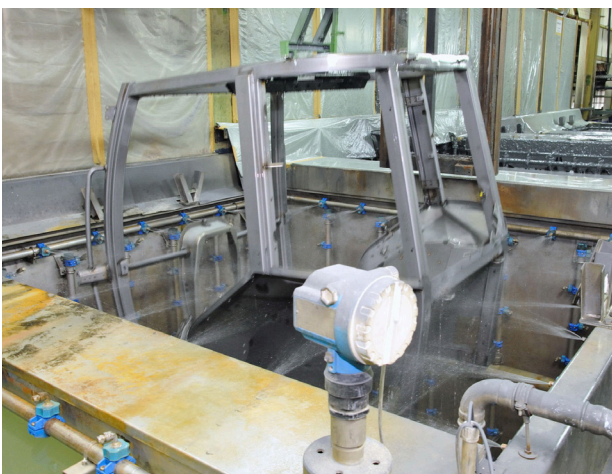
Abbildung 2: Kathodische Tauchlackierung: In aufeinanderfolgenden Tauchbecken werden die Strukturen der Traktorkabinen sowie Einzelteile vorbereitet, mit einem Korrosionsschutzlack versehen und danach gereinigt. Dafür sind große Mengen vollentsalztes Wasser nötig.
